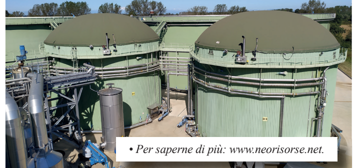
• Il "biofiltro" (a destra nel tondo) e i Digestori.
