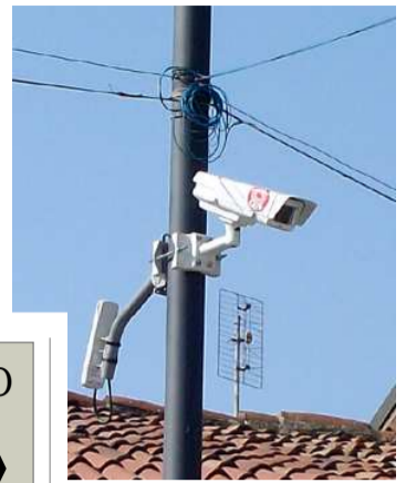
La videosorveglianza esiste già a Casorate (nella foto la telecamera di piazza Contardi): alcuni impianti sono però obsoleti, altri danneggiati. Col "Progetto Sicurezza" partirà il rifacimento complessivo di tutto il sistema.
