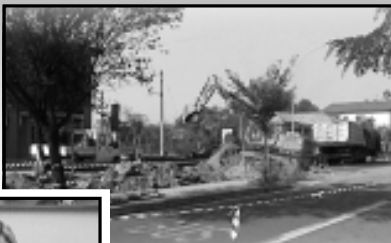
Primo Paolo De Giuli, assessore ai lavori pubblici; sopra lo scavo di via Cavour.
